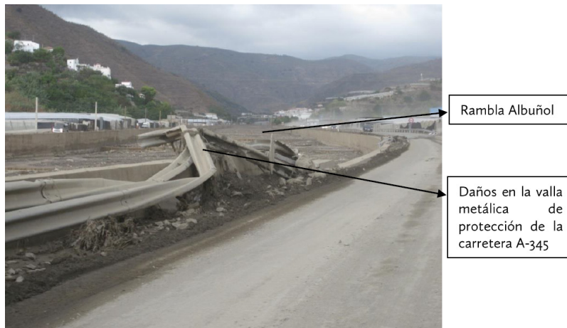
IMAGEN NÚMERO 14.- DAÑOS EN LAS INFRAESTRUCTURAS DE TRANSPORTES TERRESTRES. Autor: José Ramón Sánchez Holgado.
