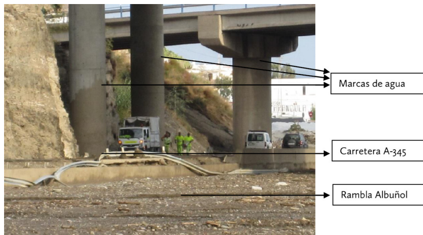
IMAGEN NÚMERO 10.- MARCAS DE AGUA QUE REFLEJA LA ALTURA QUE ALCANZÓ LA TERCERA ONDA, EN SU GOLPEO CON LOS PILARES UBICADOS FUERA DE LA CALZADA, DE LA CARRETERA A-345. Autor: José Ramón Sánchez Holgado.
