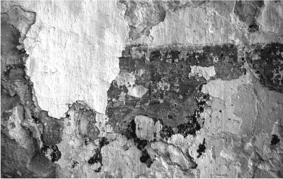
Imagen 2. Úbeda. Desprendimientos de revestimientos muestran capas anteriores de color. Fotografía: Marina Morón.
