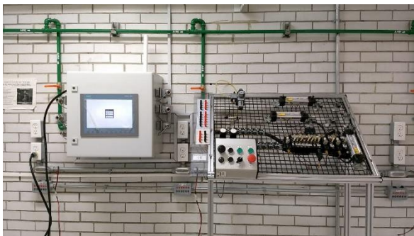
Figura 3. Estación de trabajo neumática del LAI. Fuente: elaboración propia.
