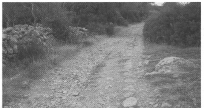
Restos de pavimento de la calzada, en el primer tramo partiendo de Ubrique.
