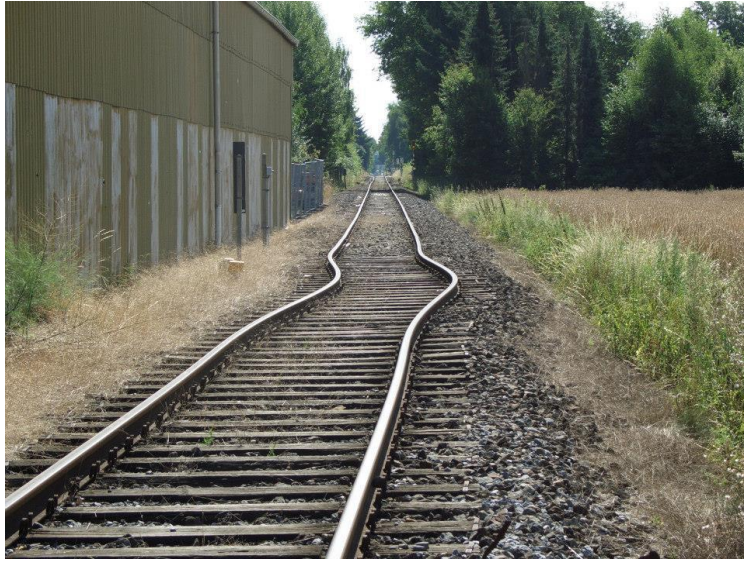
Ilustración 6 Ejemplo de desalineación de carril por alta temperatura
