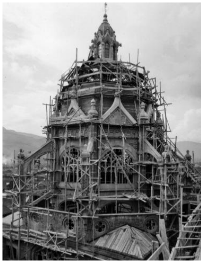
Figura 62. Construcción de la cúpula del Palacio de la Cultura Rafael Uribe Uribe en 1925
