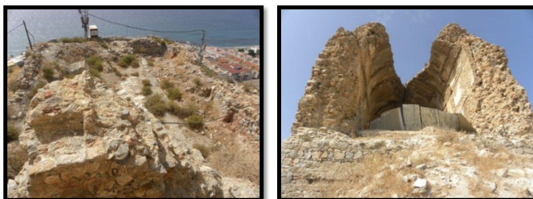
Figuras números 609 y 610.- Parte superior de la batería (Imagen de la izquierda) y fachada orientada al E del castillo de Castell de Ferro (Imagen de la derecha). Autor: José Ramón Sánchez Holgado.
