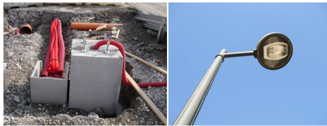
Fig.2.61. Cimentación prefabricada y arqueta prefabricada para alumbrado exterior. Punto de luz.
