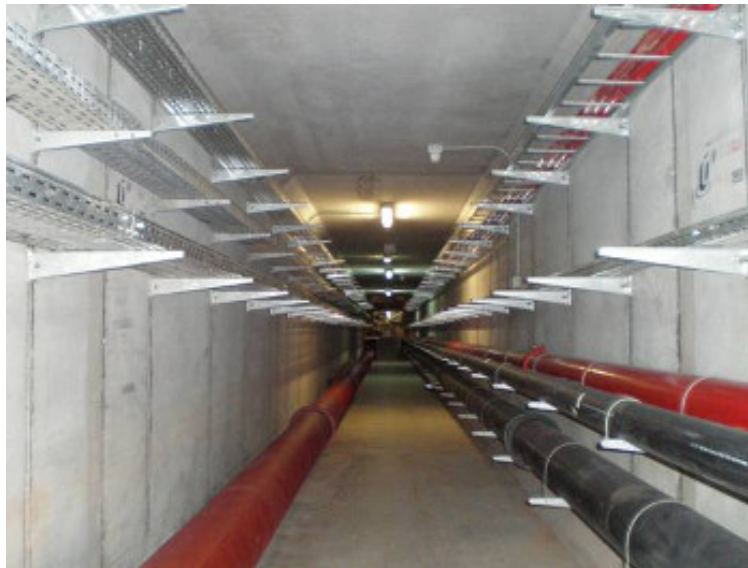
Fig. 2.33. Galería visitable de servicios Universidad Jaime I de Castellón
