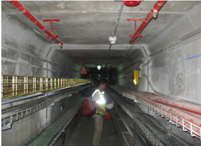
Fig. 2.32. Galería visitable de servicios del Aeropuerto de Málaga
