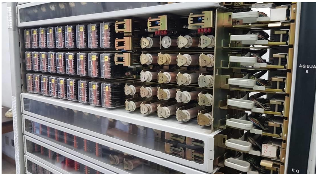
Figura 3.47. Enclavamiento electromecánico con relés modulares. Enclavamiento de Granollers – Canovelles. Hernández Yagüe, 2020
