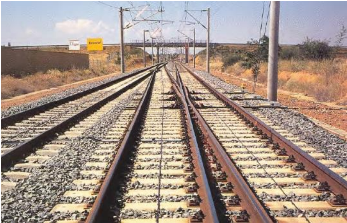
Figura 3.33. Escape con corazón móvil del desvío de la línea del AVE Madrid – Sevilla. RENFE – AVE (1992).
