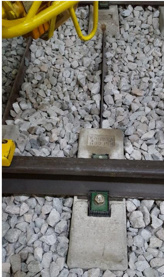
Figura 3.22. Traviesa con sus sujeciones. Elaboración propia.
