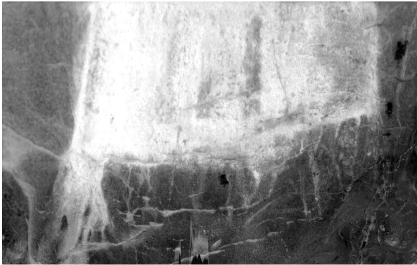
Figura 96: Zonas afectadas por lixiviación y recubrimiento calcítico.
