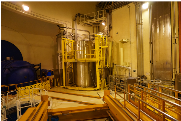
(c) Contenedor en posición vertical en contención.
