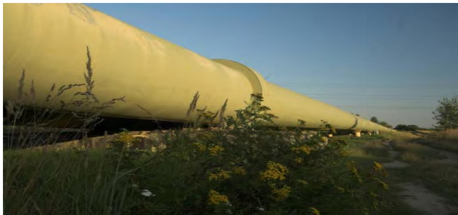
Ilustración C-2. Tuberías para el transporte de calor a gran escala (2 x DN 1200) entre Melnik y Praga [477]
