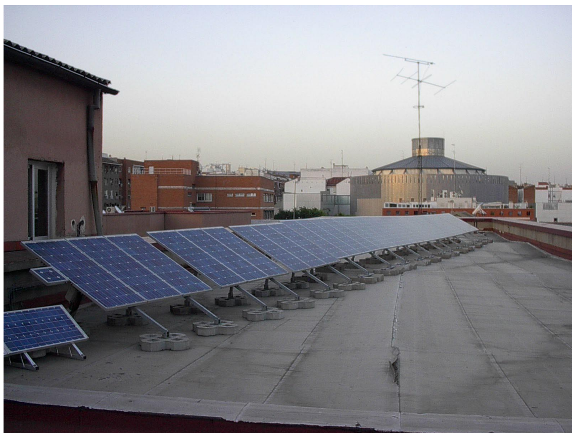
Figura 6.2. Vistas de la ampliación (2ª fase) de la instalación fotovoltaica E.U.I.T.I./U.P.M.
