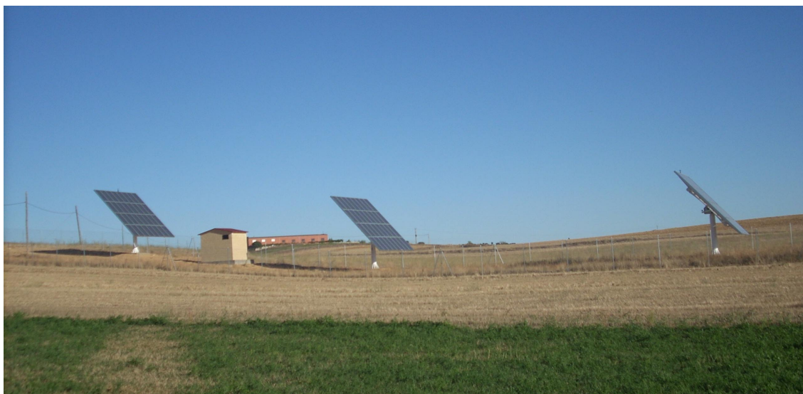
Figura 5.22. Pequeña instalación fotovoltaica, con unos 15 kWp.
