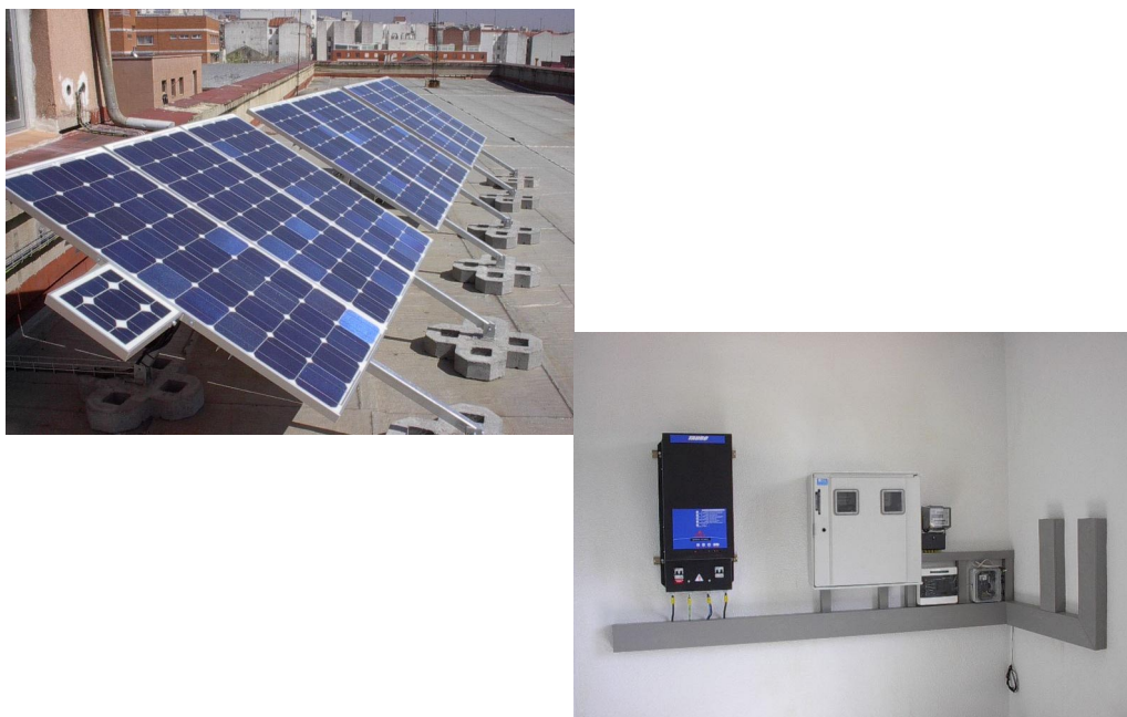
Figura 6.1.- Vistas de la primera fase de la instalación fotovoltaica.
